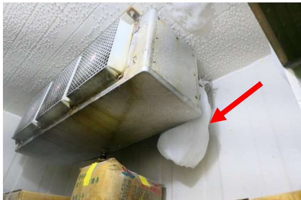
冷凍庫管線結冰成團
