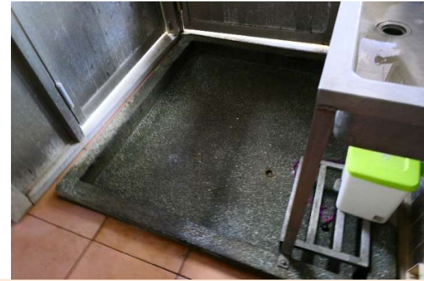
泡鞋池氯液於作業期間被放光
