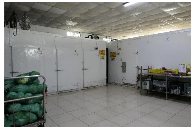
未見常見缺失(冷藏庫門板 霉斑)
