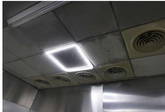
4/9:請留意：油炸區輕鋼板變形不平整
