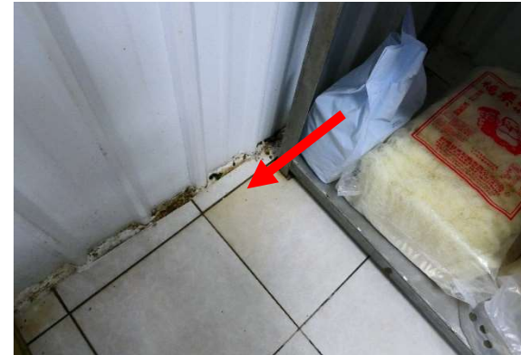
3/26 :乾料庫房角落地面積水潮濕
