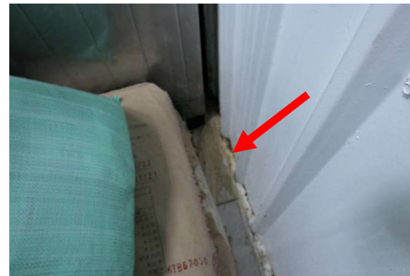
5/31 :乾料庫房另一角落 地面有積水且有潮濕食材
